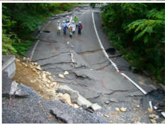
写真-1 道路の陥没と前方傾動
